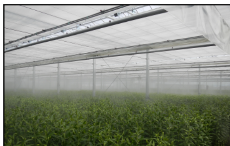
省力化を実現する設備
